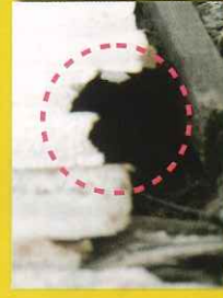
外壁波トタンの腐食による破れ
