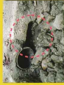
ポリ排水管添いに床下に侵入。管の中は出口がない。
