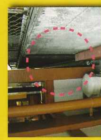
店舗基礎コンクリートの破損穴 U字側溝から穴に入る。
