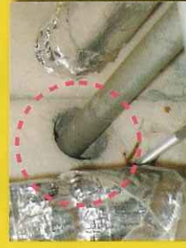
設備配管貫通穴。塞ぎ忘れによる。
