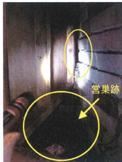
その奥にはさらに隙間が確認できる
