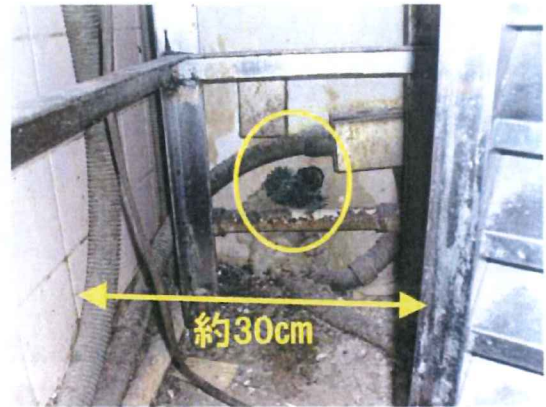
防鼠ブラシで閉塞した跡があるが横に新たな進入孔確認
