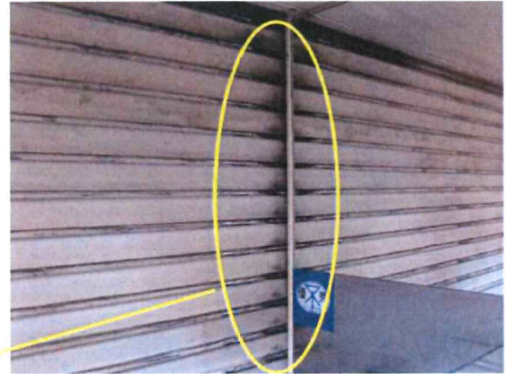
←↑シャッター部分にネズミ侵入形跡確認
