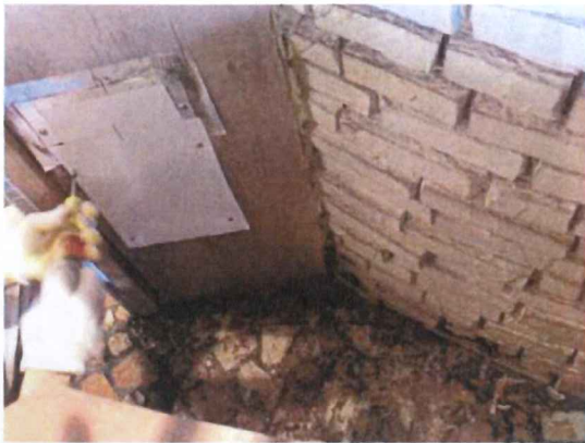
閉塞したプレートを外すと 空洞になっており以前は営巣箇所として異臭を放っていた→
