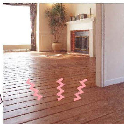
腐れ 床がきしんだりする
